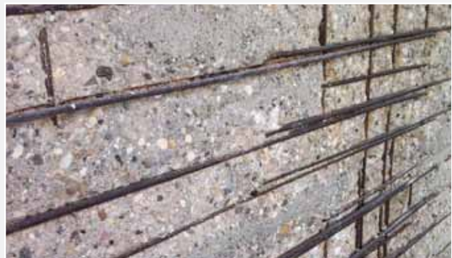
Корозия на армировката и обрушване на бетонното покритие
