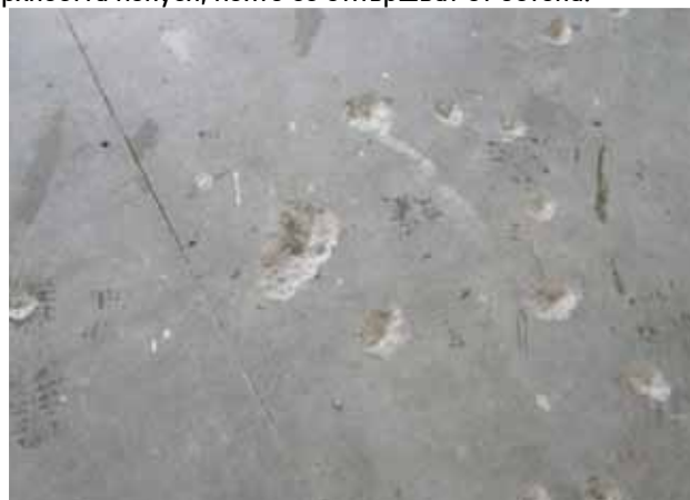
Феномен на откършване на конус ни тела от външния бетонен слой.
