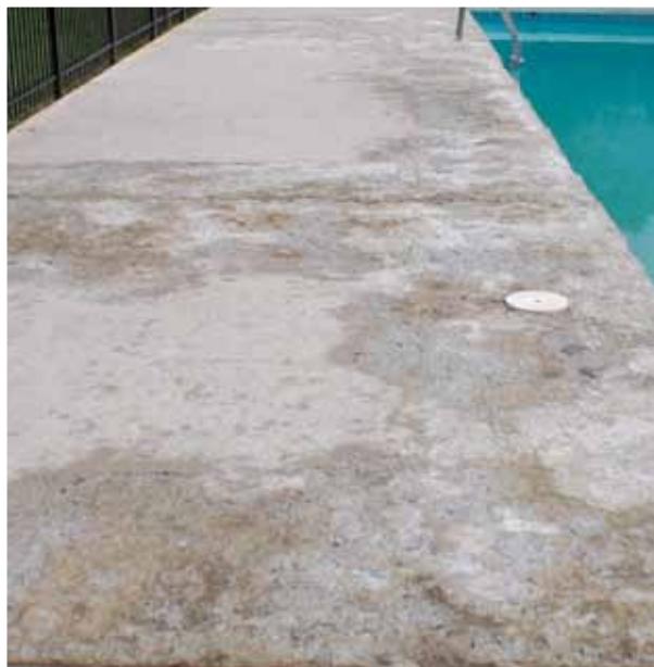
Ефект от "отмиване" на бетонната повърхност.
