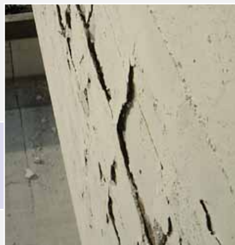
Подуване и образуване на люпи по повърхността на бетона, вследствие на образуване на еtringит.
